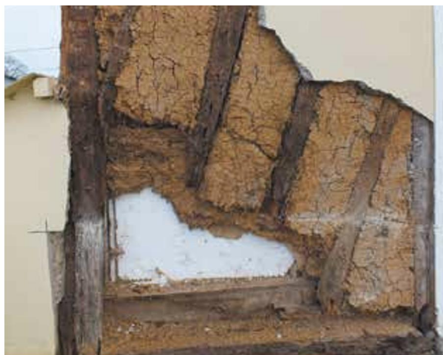
Pan de bois dégradé : le polystyrène côté intérieur a bloqué le séchage du mur vers l'intérieur. ©CoDEM
